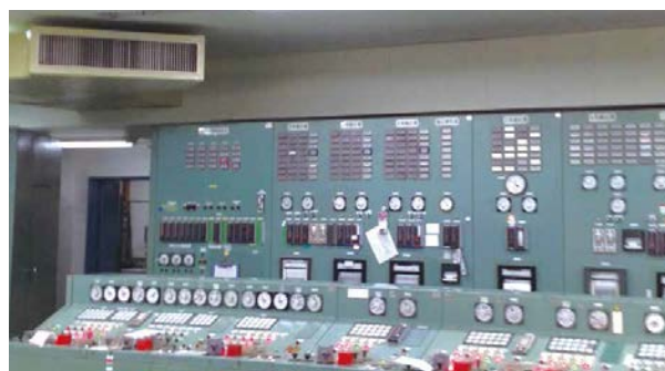
図1 中央操作室内の制御盤
