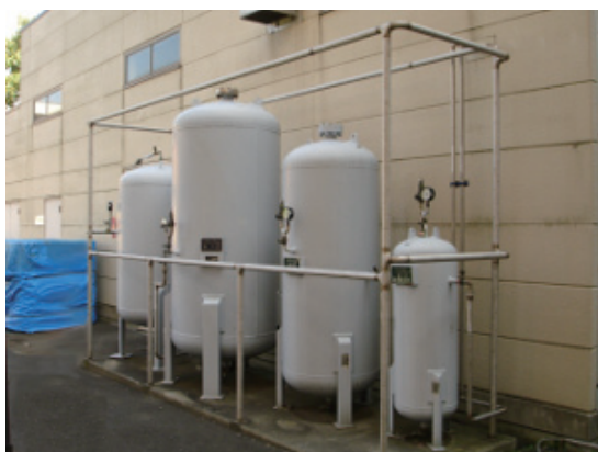
図2. リカバリータンク(左3基), バラストタンク(右1基)
