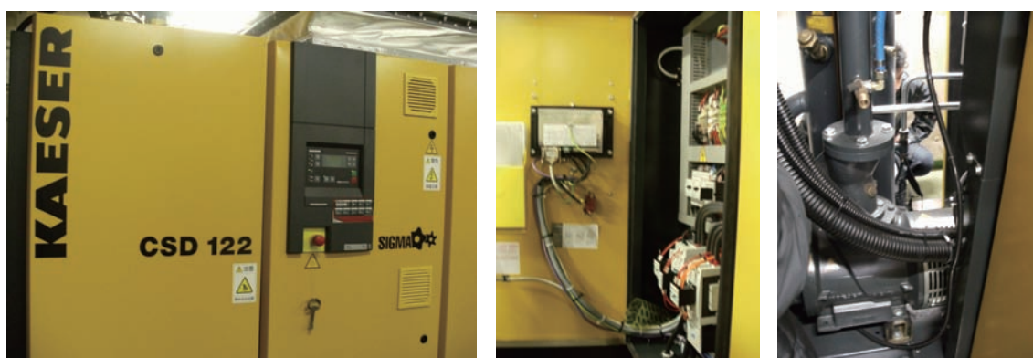
図 5. 液化用圧縮機（左：外観、中央：電気系統、右：内部）
