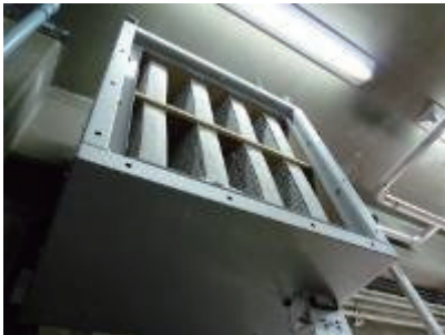
図5. 塩害対策用のフィルター
