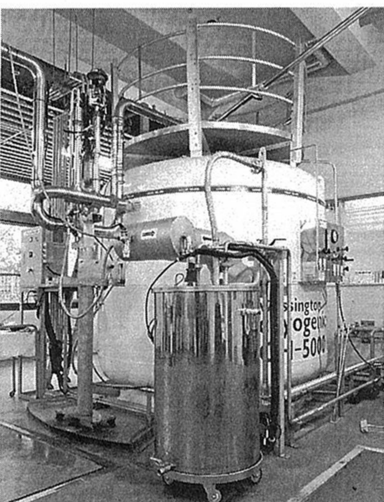
液化したヘリウムを貯蔵するタンク。5000リットルの液体ヘリウムを貯蔵できるが、学内の需要がこれを上回りつつある
