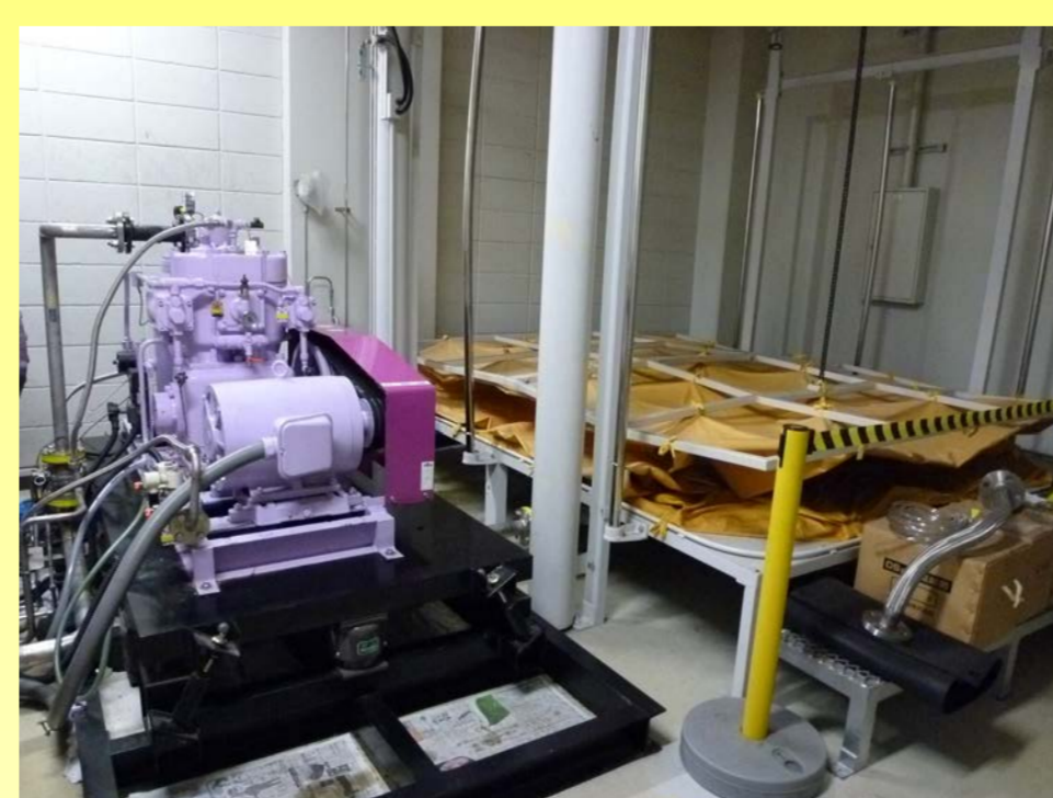
理学部内サブセンター (理学部新1号館) ・圧縮機 型式:5WMC(東亜潜水機) ・サージタンク 容量:2m 3 ・ガスバック 容量:15m 3
