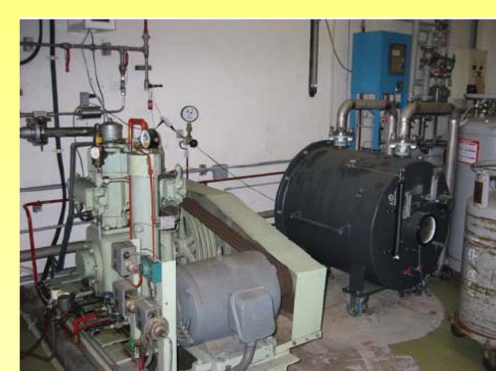
工学部内サブセンター (工学部6号館) ・圧縮機 型式:5WMC(東亜潜水機) ・サージタンク 容量:4m 3 ・ガスバック 容量:3m 3
