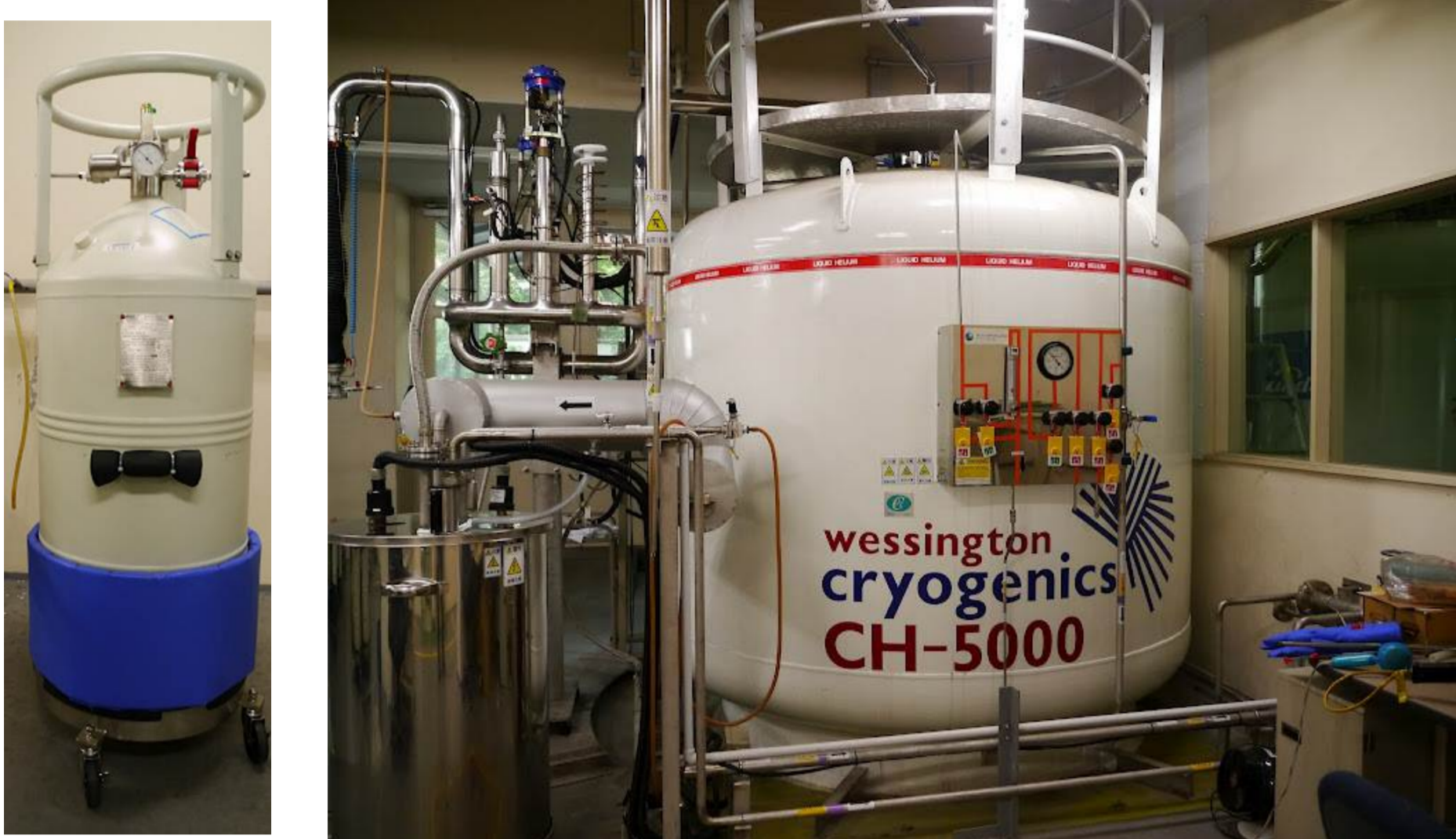
液体ヘリウム貯槽 Wessington CH-5000 貯槽容量 5000ℓ
