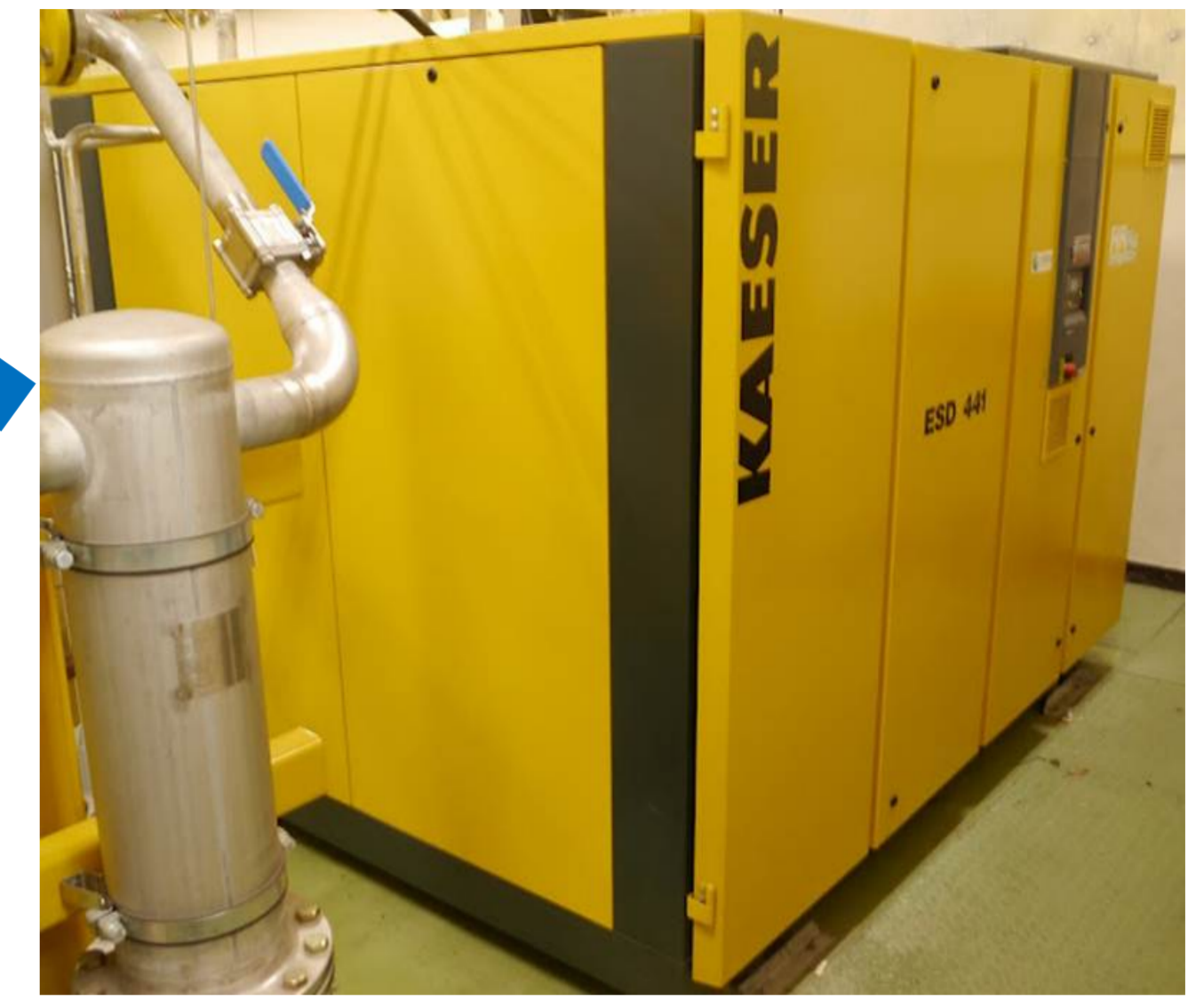
液化用圧縮機 KAESER社製 ESD441 吐出圧0.95MPa
